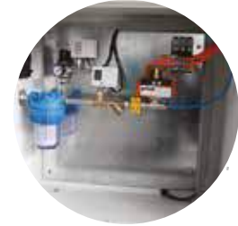
Pnömatik Kontrol Merkezi Pneumatic Control Center
